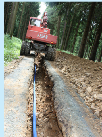
Die Verteilung des Trinkwassers erfolgt über Rohrleitungen mit Durchmessern von 200 bis 1200 mm.
