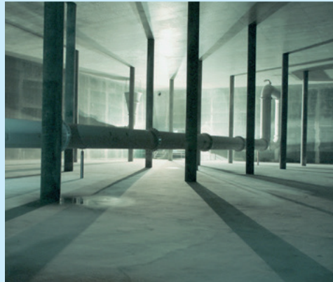
Ein Hochbehälter speichert bis zu 20 Millionen Liter Trinkwasser, um Bedarfsspitzen abdecken zu können.
