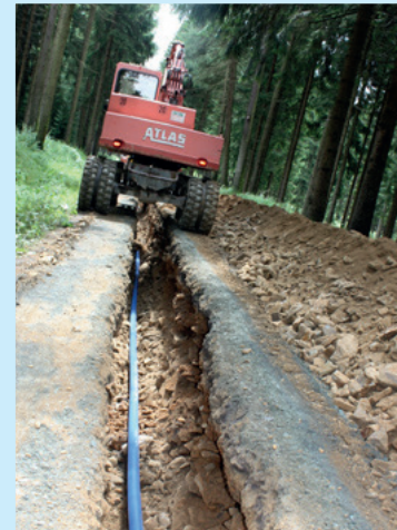
Die Verteilung des Trinkwassers erfolgt über Rohrleitungen mit Durchmessern von 200 bis 1200 mm.
