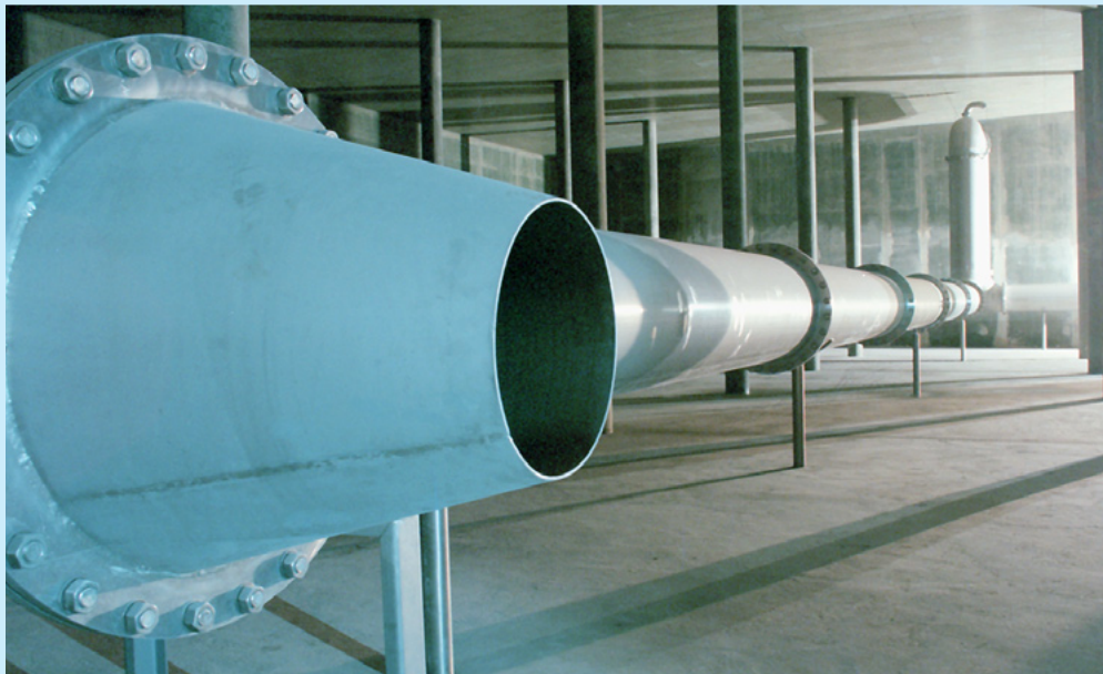
Damit die sehr gute Qualität des Trinkwassers auf dem Transport nicht beeinträchtigt wird, müssen Rohrleitungen, Wasserbehälter und Pumpwerke ständig überprüft und instand gehalten werden.
